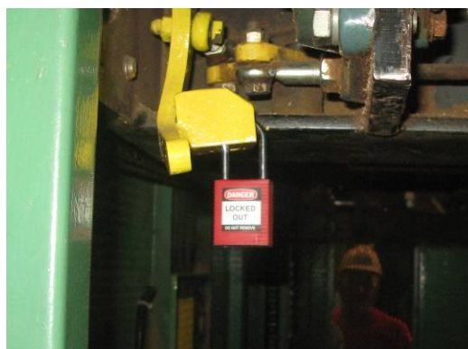
Sistema de cadeados de bloqueio
