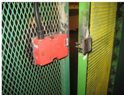
Trava elétrica interligada ao Rele de Segurança
