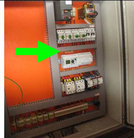
Foto 6 – Painel geral da máquina misturadora
