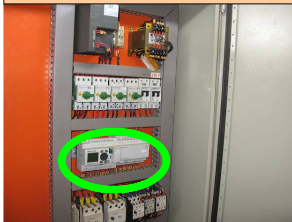
Foto 16 - Painel de controle
