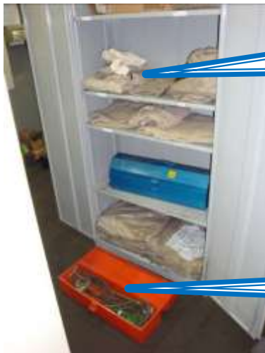
Armário instalado na área dos painéis
