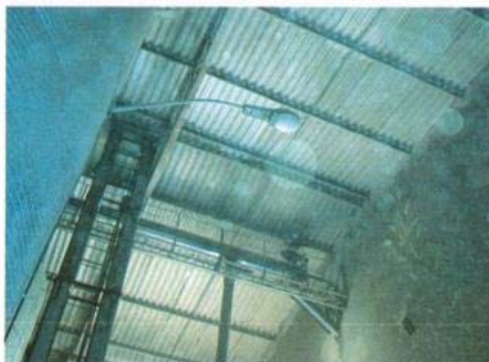
Figura 1: Interior do armazém onde ocorreu o acidente. À esquerda, silo e elevador de grãos
