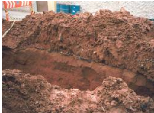
FOTO 3 – VALA COM TERRA DEPOSITADA NA BORDA
