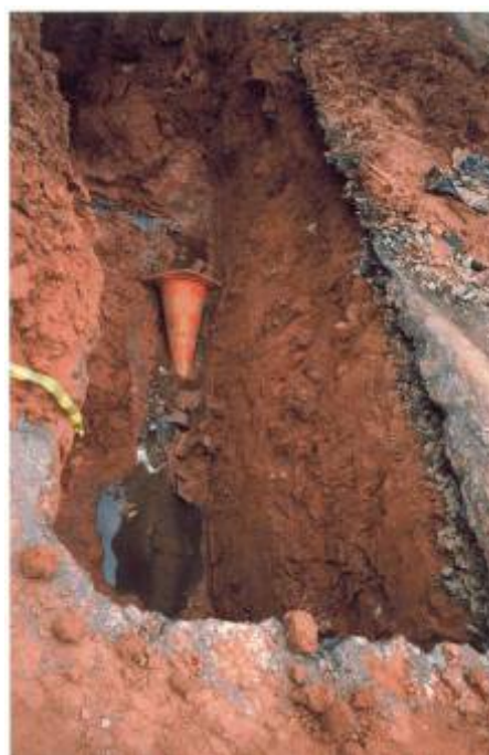
FOTO 5 –PRESENÇA DE ESGOTO NA VALA.
