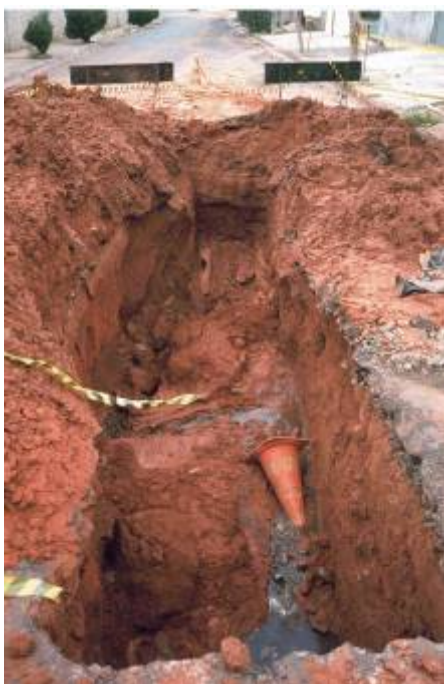
FOTO 4 –MANILHA QUEBRADA AO FUNDO
