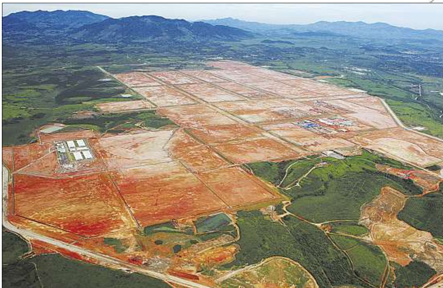
VISTA AÉREA das obras do Comperj: um operário morreu imprensado contra uma pilastra por uma retroescavadeira na terraplanagem
